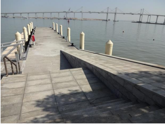
写真 5. 角度が急で、手すりがない スロープ (マカオ)
