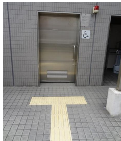
写真 31. 障害者用トイレの前に点字ブロックを設置するのは不適切である (名古屋港)
