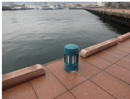
写真 17. 電燈を配置した柵の隙間から海に転落する危険性がある（佐世保港）
