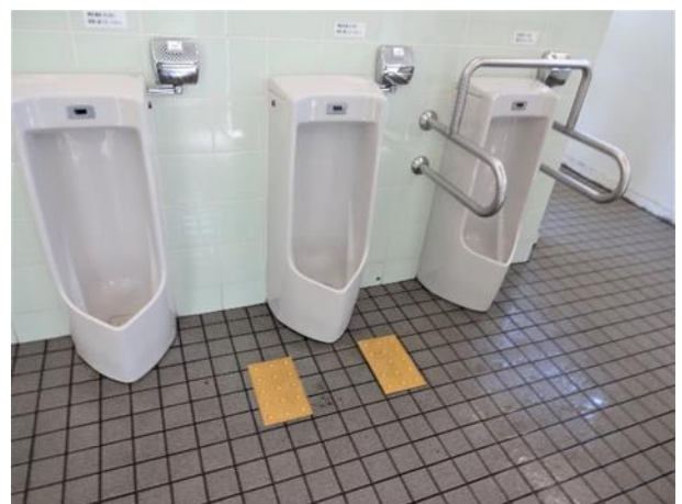
写真 18. 小便器の前の点字ブロック：好事例 東本願寺（京都）
