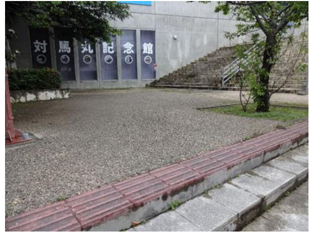
写真 7. 警告ブロックを設置すべきところに 誘導ブロックが設置されている： 要改善事例 対馬丸記念館 (沖縄)
