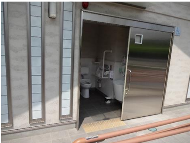
写真 10. 多目的トイレの入り口に設置されている 点字ブロック：要改善事例 富岡製糸場 (群馬)
